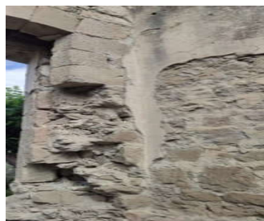
Рисунок 3 – Вид разрушенной кладки обрамления арочного проема
